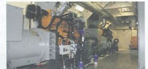
Twee generatorensets van 240 kVA per stuk drijven het geheel aan.
